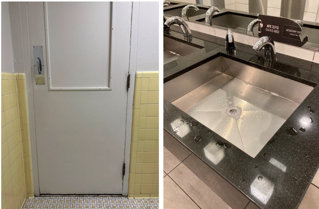
Figure 36 Photo de toilettes qui ont des lacunes d'accessibilité
